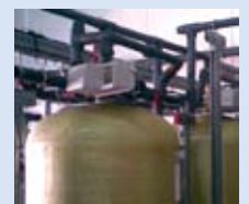
Комплекс оборудования для удаления механических примесей, взвесей и растворенного железа
