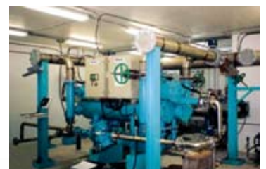
Станция очистки воды для удаления лямблий (136 м 3 /час, 3 мкм)
