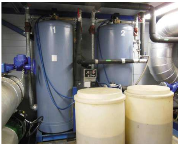
Водоподготовка котельной, пос. Варандей
